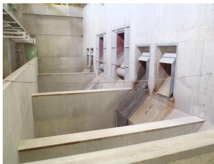
灰出しピット
